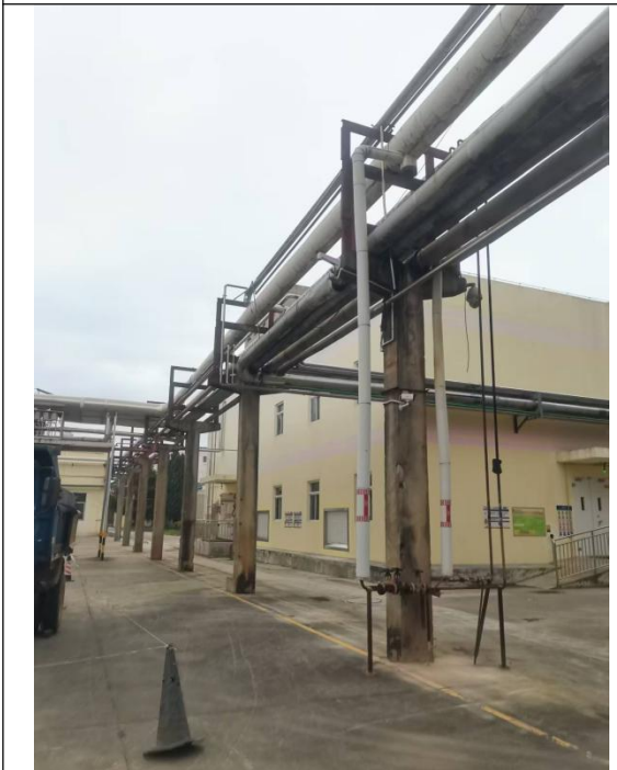
华狮啤酒厂内在用的蒸汽管道
