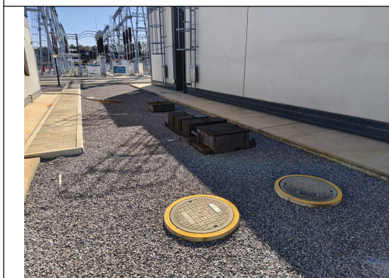
地埋式污水处理设施
